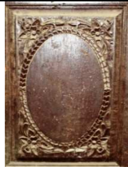
لوحة (١٧) تفاصيل لأحد الحشوات الخشبية بأحد أبواب وحدات الطابق الأرضي ببيت الكاتب.
